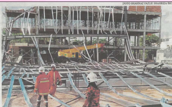
Tiang dan kerangka bumbung runtuh di sebuah tapak pembinaan di Lorong Perusahaan Maju 8, Bukit Mertajam, yang meragut tiga nyawa, semalam
