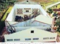
LAPANGAN Keadaan Dewan SMK Wafiq Tapai selepas bumbung runtuh.
