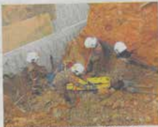
ANGGOTA bomba mengeluarkan mangsa yang dihempap konkrit selepas sebuah jambatan yang dalam pembinaan runtuh di Jalan Pengarang ke Sungai Rengit, Kota Tinggi semalam.
