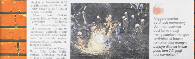
Anggota bomba bertindak memotong dan memecahkan besi konkrit bagi mengeluarkan mangsa tertimbus di bawah runtuhannya dan mangsa berjaya di bawa keluar pada jam 7.21 pagi tadi (semalam).
